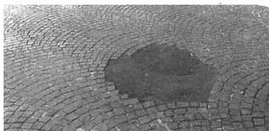
Rappozzamenti in Via Libertà
